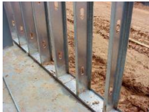
مکان عبور کابل از درون دیوار LSF
